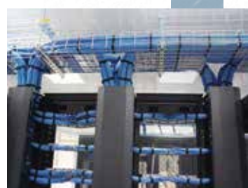
2 线缆根根可见，全面管控布线质量。
